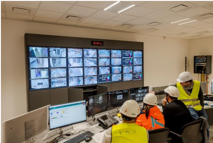
Le poste de commandement centralisé de la gare Saint-Denis – Pleyel. © Société des grands projets / Sylvain Cambon
