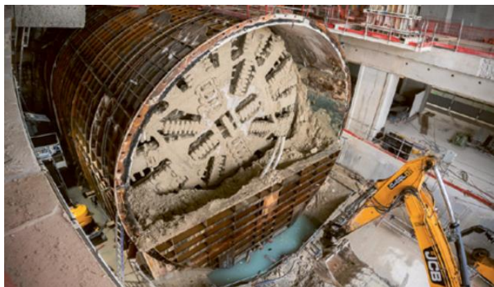
Le tunnelier Sarah lors de son second passage, à l'été 2022. © Société des grands projets / Armand Wattel
