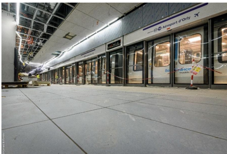
Pose du sol emblématique sur le chantier de la gare Saint-Denis Pleyel ©Kengo Kuma Associates / Gérard Rollando / Société des grands projets
