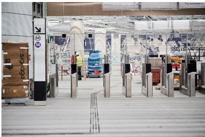
Ligne de contrôle en cours d'installation sur la gare Aéroport d'Orly ©Groupe ADP / Lucille Pellerin / Société des grands projets
